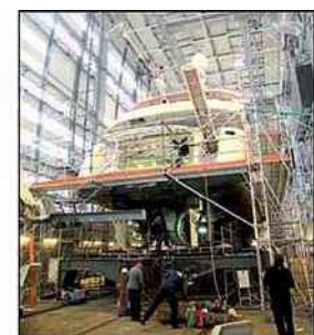
La cabine de peinture de Monaco Marine, longue de 90 m, a un système de chauffage et de ventilation.
